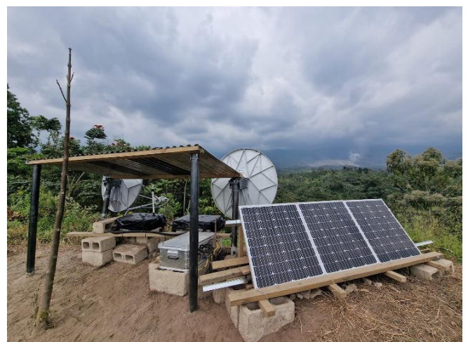
図3：活火山の斜面から6100メートルの地点に設置した最初の観測装置。
